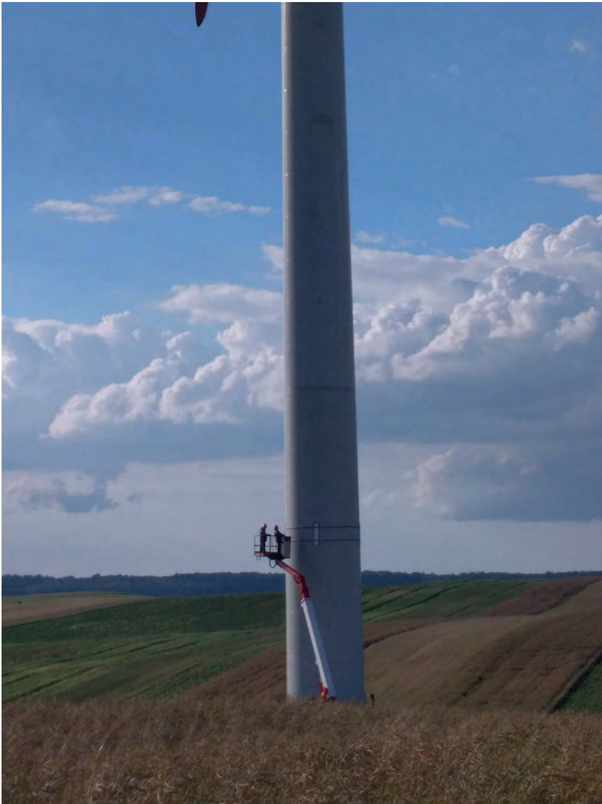
Fot. 2. System Bioseco zainstalowany na południu Polski, 2018 r.
