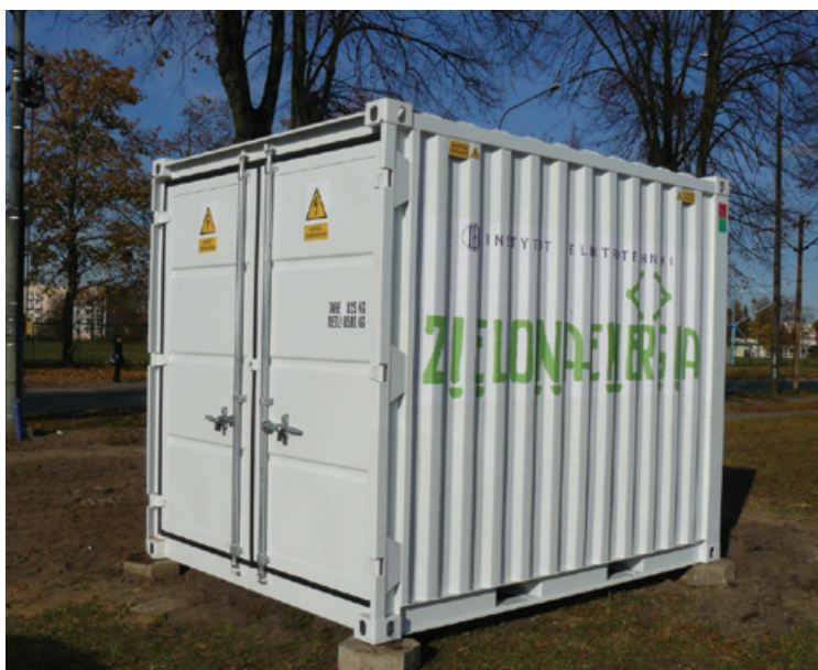
Podstacyjny zasobnik super-kondensatorowy 2 MJ; 0.15 MW
