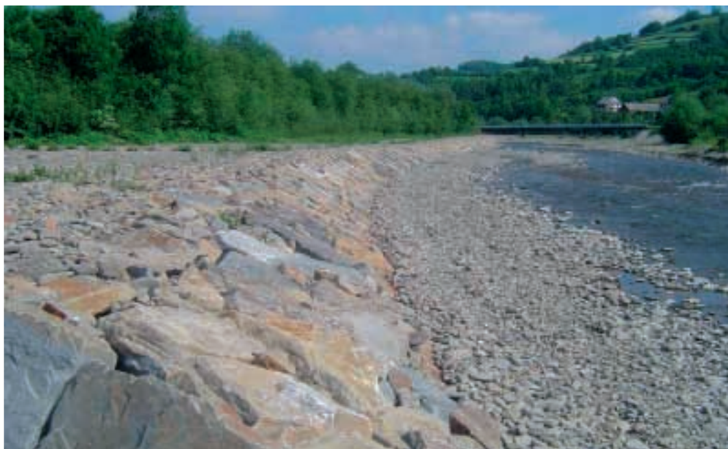
Fot. 16. Odbudowane wały ochronne wzdłuż potoku „Kamienica” Photo 16. Reconstructed protection dykes along „Kamienica” stream
