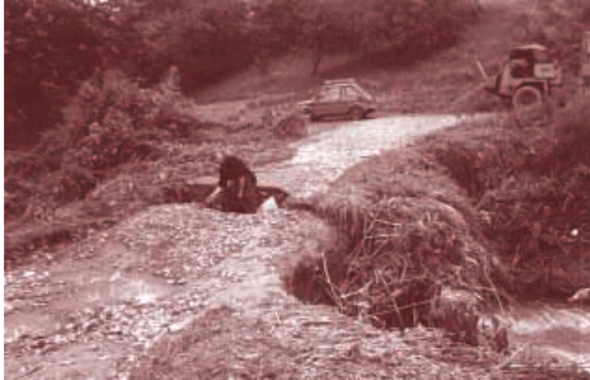
Fot. 22. Fragment zniszczonej drogi gminnej Mikłaszówka – Połanek Photo 22. Section of the damaged Mikłaszówka – Połanek gmina road
