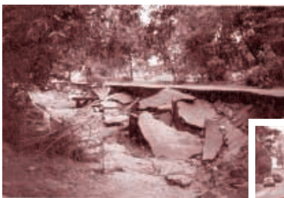
Fot. 39. Widok na zniszczoną drogę Photo 39. View of the damaged road
