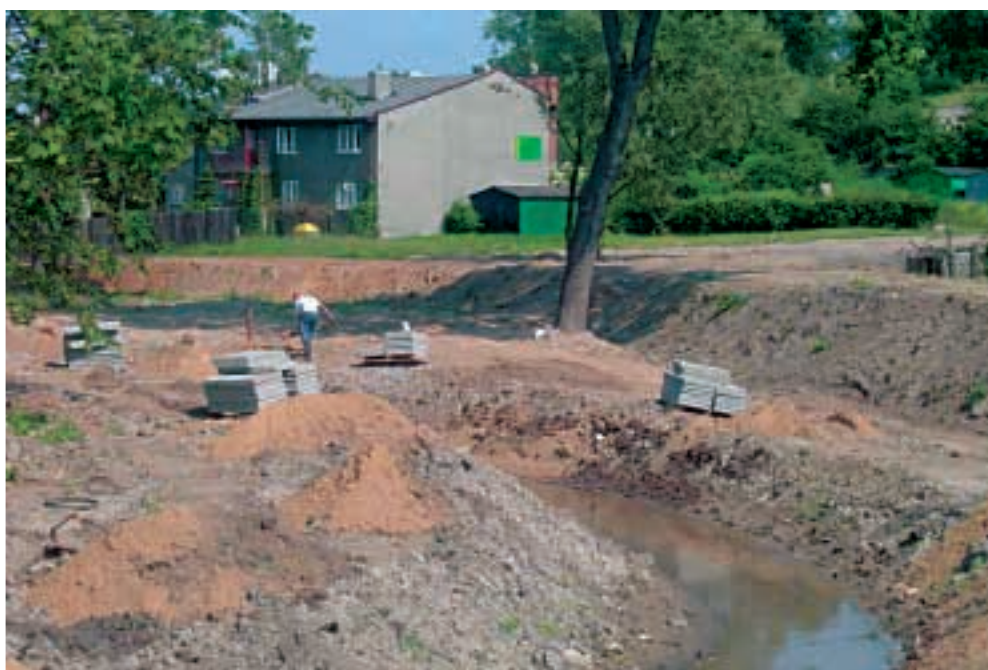
Fot. 45. Prace nad rekonstrukcją obwałowania i zabezpieczeń przeciwpowodziowych rzeki Photo 45. Work on reconstruction of embankment and river flood protection system
