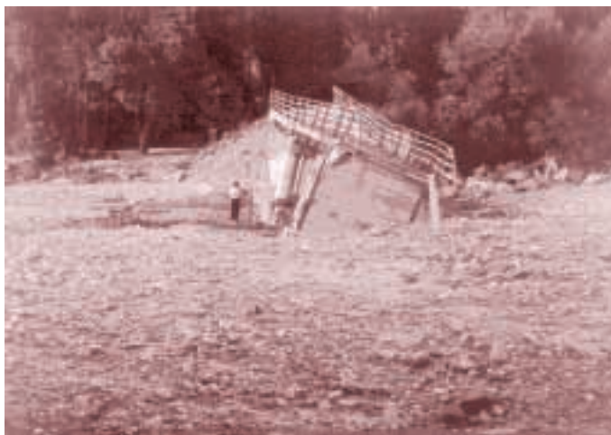
Fot. 10. Widok na zniszczony przez powódź most w Budzowie Photo 10. View of the bridge in Budzów destroyed by the flood
