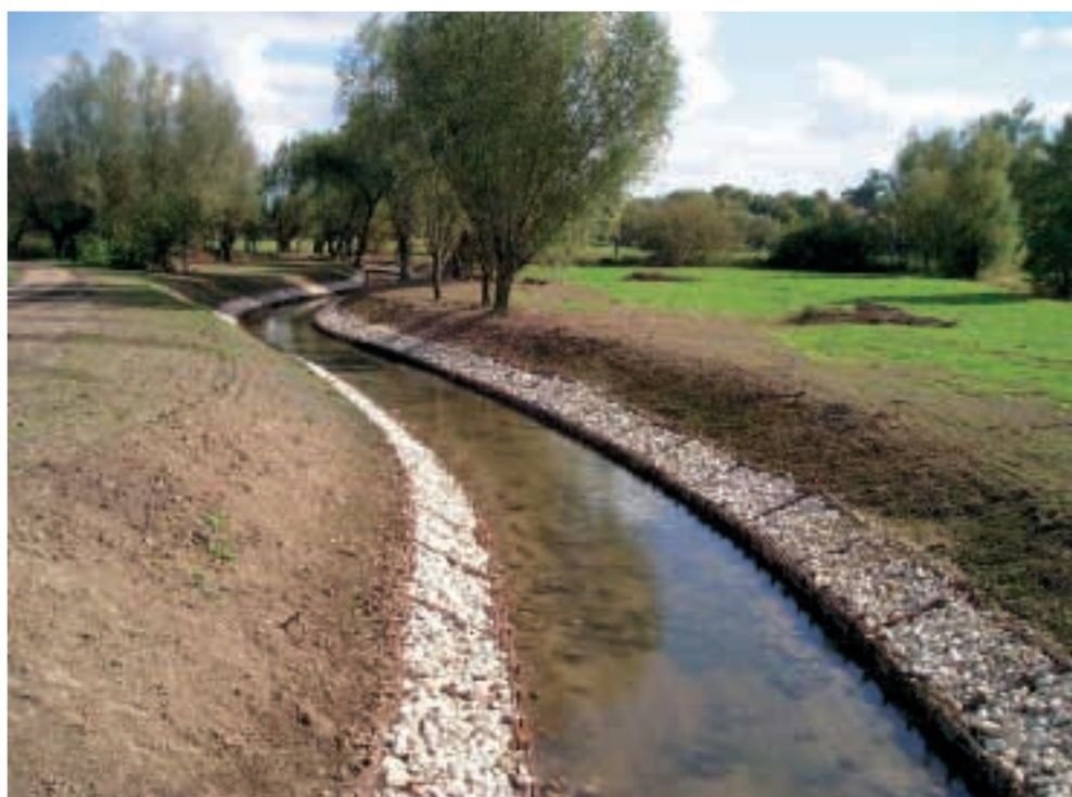
Fot. 35. Efekt końcowy prac naprawczych Photo 35. The final result of repair works
