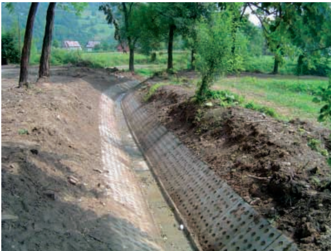
Fot. 19. Widok na zrekonstruowany rów melioracyjny Photo 19. View of reconstructed drainage ditches
