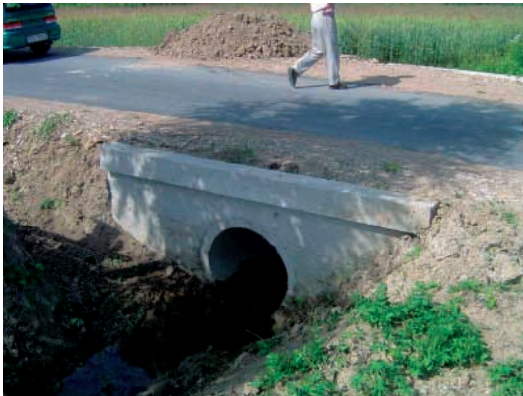
Fot. 29. Widok na wyremontowany przepust i drogę Photo 29. View of the reconstructed culver and road
