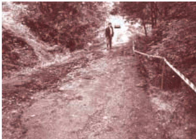
Fot. 21. Widok na zniszczoną drogę Photo 21. View of the damaged road
