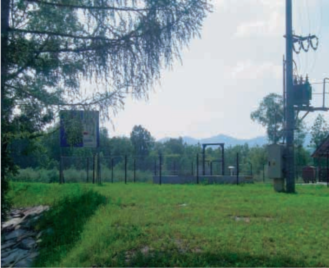
Fot. 17. Widok na zabezpieczoną oczyszczalnię ścieków Photo 17. View of the protected water treatment plant
