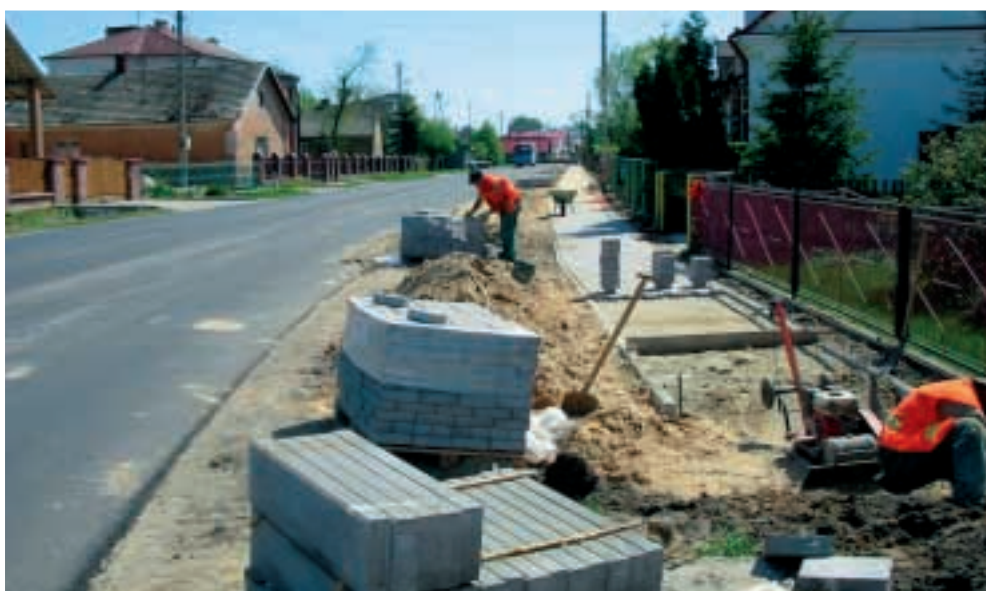
Fot. 25. Prace nad odbudową zniszczonej drogi powiatowej Photo 25. Work on reconstruction of damaged poviast road
